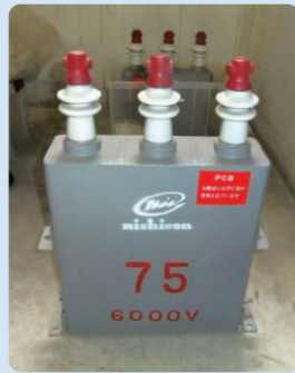
電力用コンデンサー
